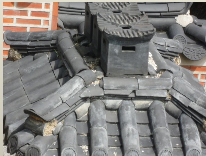
굴뚝 보수 전(기와이완 및 파손)
