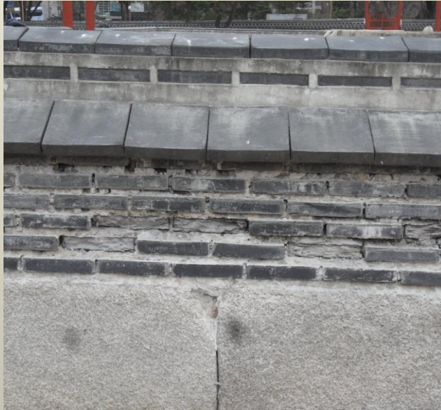
줄눈 탈락 및 전벽돌 파손
