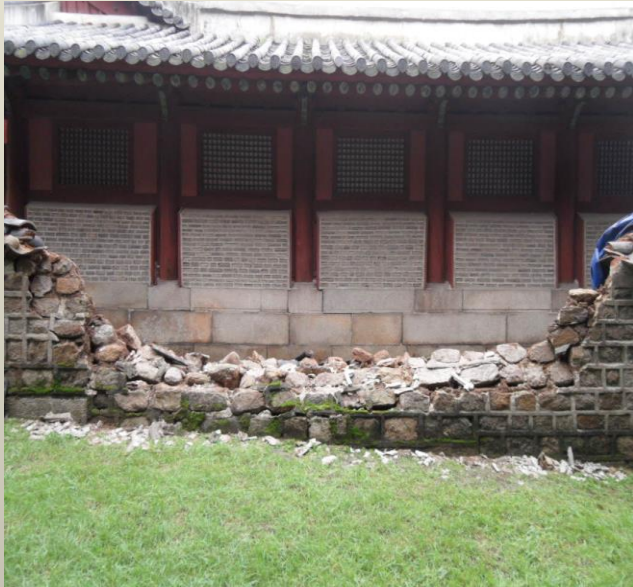
담장 붕괴 현장
