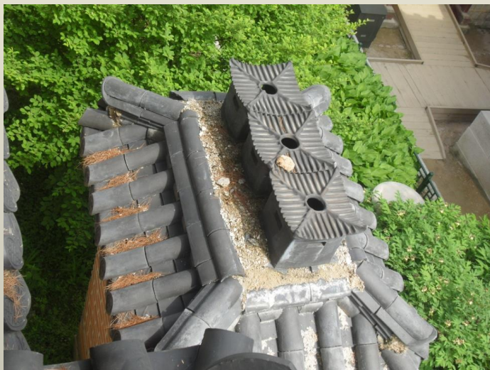
굴뚝 보수 전(연가주변 미장균열)
